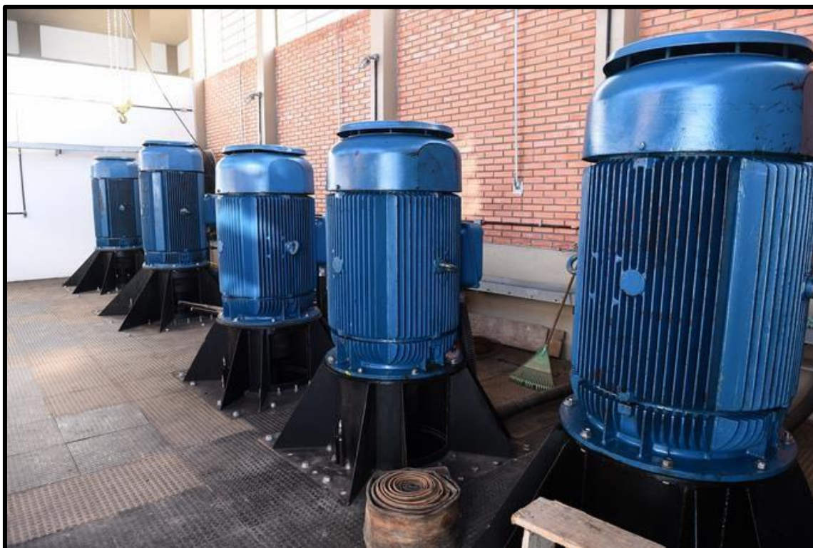
Casas de bombas deixaram de funcionar durante a enchente de maio (Foto: Ederson Nunes/CPMA)
